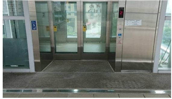
圖 8 電梯周邊設置截水溝排水
